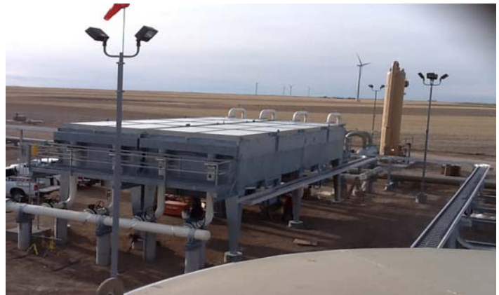
Fin Fan and Tower Area
